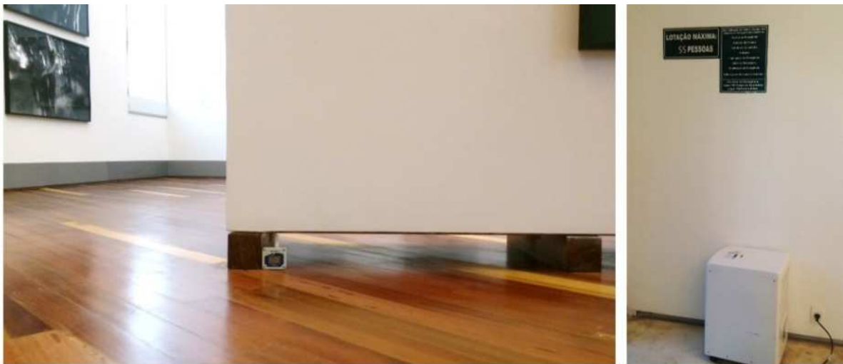
Logger de controle de climatização, Galeria Claudia Andujar / Desumidificador e sinalização, Galeria Mata.
