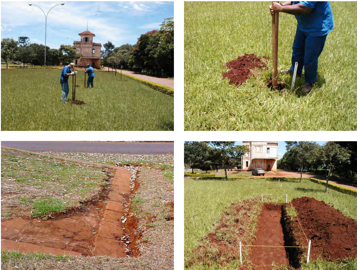
Figura 65. Procedimentos de escavação (cota negativa) no entorno do prédio principal da Estação Ferroviária de Piraju.
