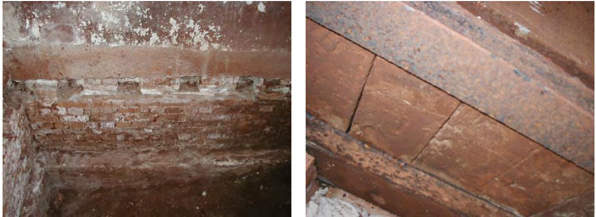
Figura 64. Desaterramento dos porões (aterrados em 1992); detalhe da sustentação de uma das gateiras de ventilação.
