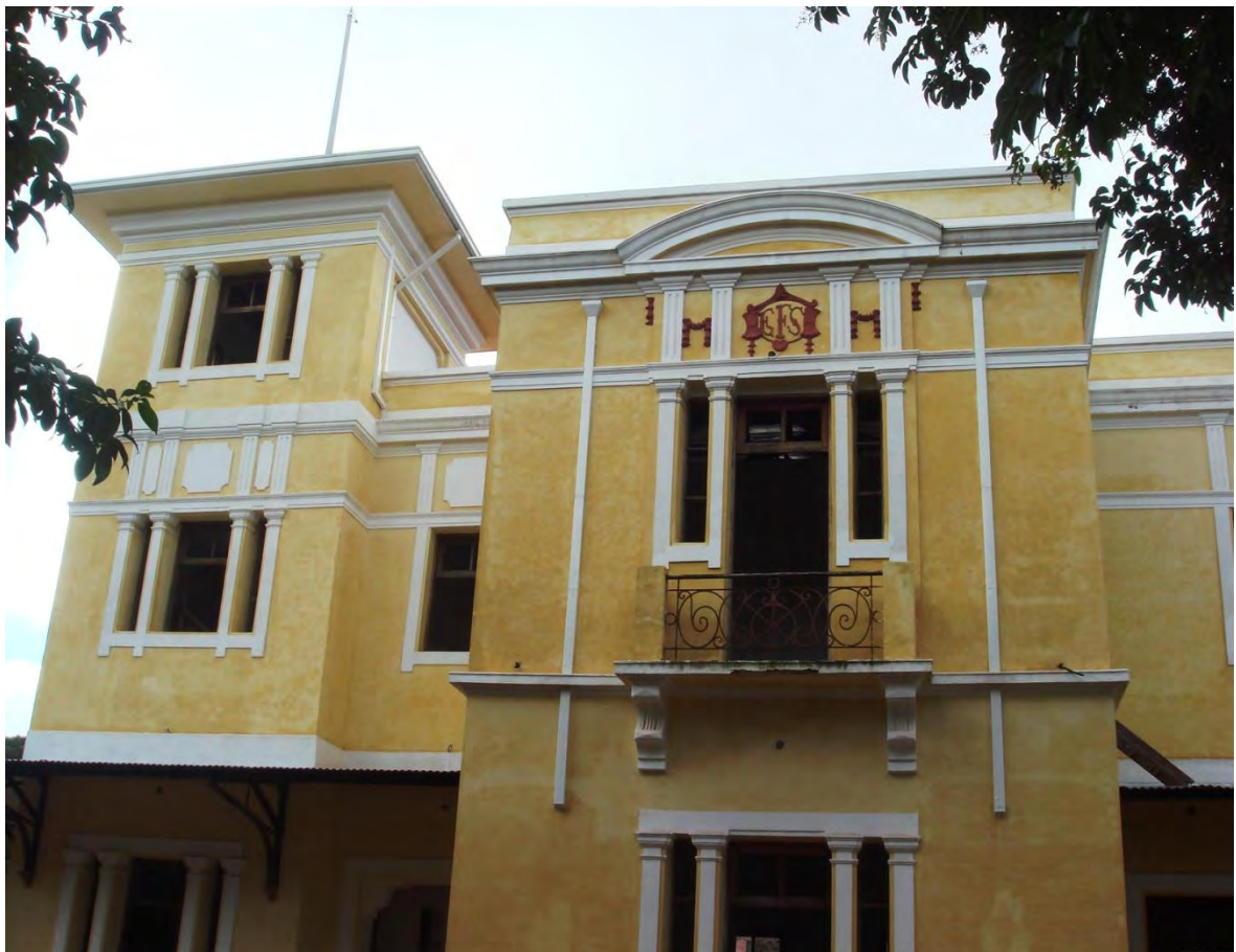
Figura 62. Cenas do andamento do restauro da Estação Ferroviária de Piraju, sede do programa Estação da Memória
