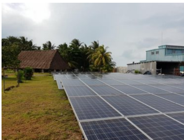
Figura 14 - Plantas solares e gerador instalados ao lado do edifício do museu e de sua maneaba. Foto: Marcelo Murta, fevereiro de 2019.
