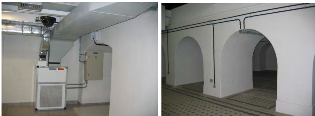
Figuras 126 e 127 - MNBA: Reserva Técnica. Arcos estruturais, pisos de ladrilho hidráulico e equipamentos de climatização e segurança.
