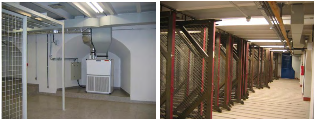
Figuras 128 e 129 - MNBA: Reserva Técnica. Arco estrutural, equipamentos de climatização e combate de incêndio. Antigos trainéis em madeira.
