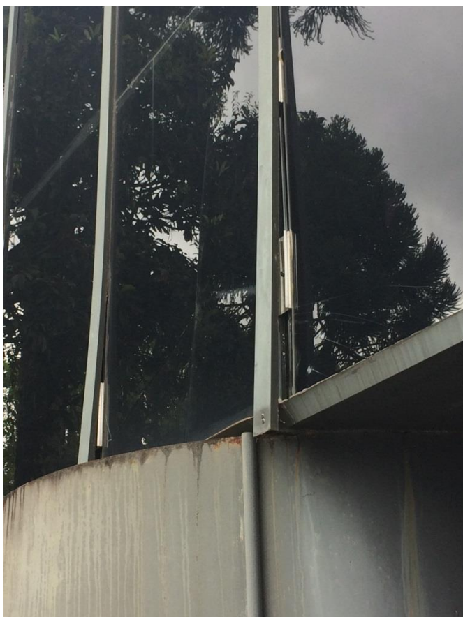
Figura 44 – Fachada do anexo, construído em 2002. Nota: Deslocamento dos vidros.
