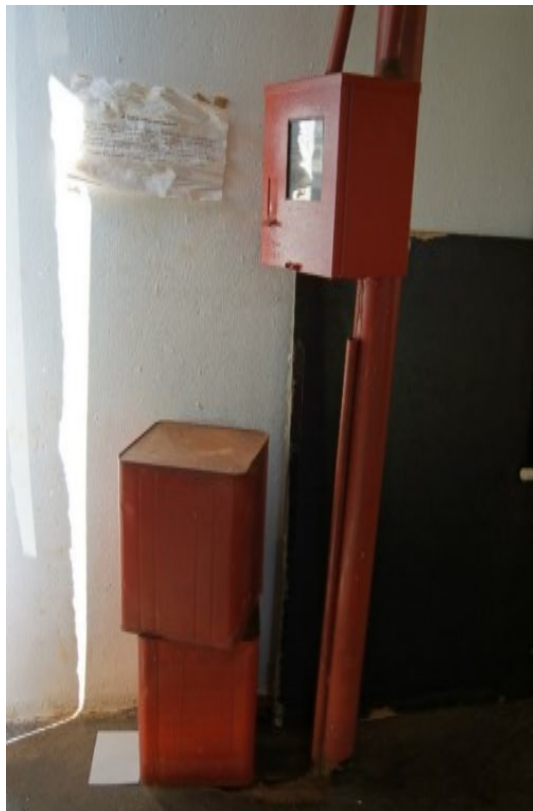
Figura 73 . Poste de energia elétrica na entrada do espaço expositivo
